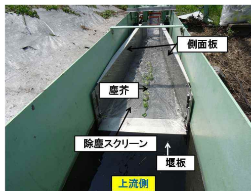
図2 農業用水路に設置した除塵装置
