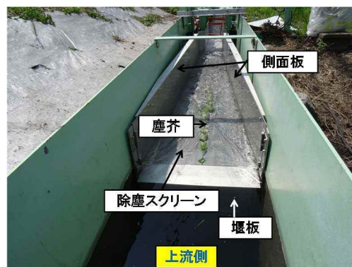
図2 農業用水路に設置した除塵装置
