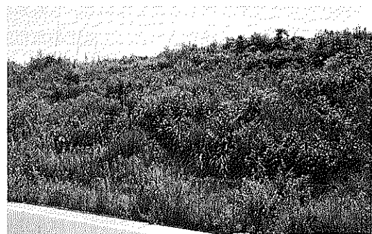
Photo 7 復旧工事5年後の法面 (Fig. 7のA) Slope five years after reconstruction
