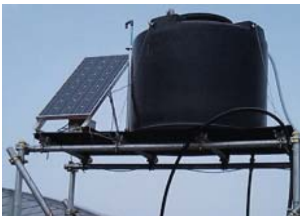
写真1 間欠式自動灌水装置の貯水タンクとソーラーパネル
