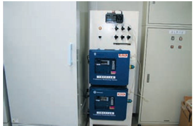
自動エチレンガス濃度連続測定装置
