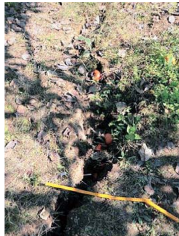
b 地割れ部拡大(幅20cm程度)
