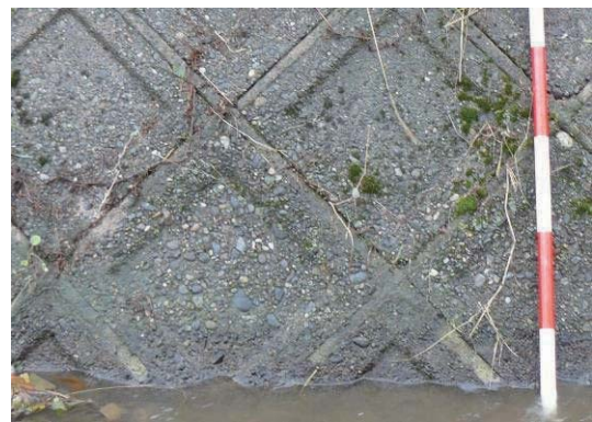
Fig. 57 現地水路ブロックの摩耗状況 Eroded state of concrete blocks in an actual canal
