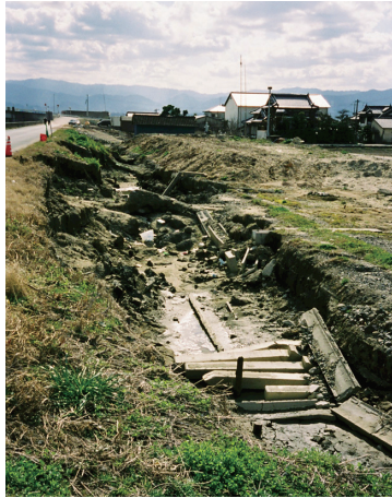
(a)旧不知火干拓地における農業用排水路の破損
