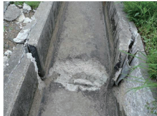
Fig.2-10 側壁から底版にかけて発生した躯体コンクリートの損傷 Damages of canal joint at the sidewall and base concrete
