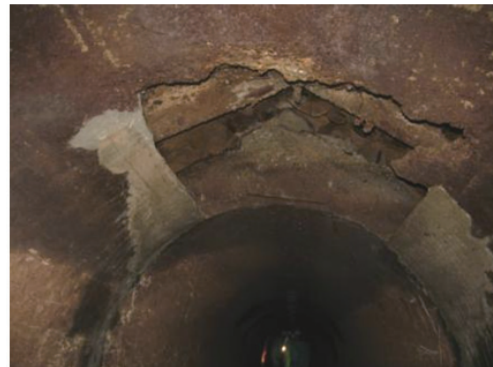
Fig.3-14 トンネル覆工の崩落の例 Collapse of a tunnel concrete lining
