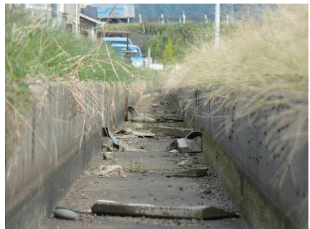
Fig.2-27 コンクリートが連続して剥落した状態 Repeated breakage of concrete at successive canal joints
