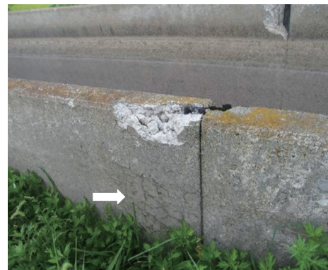
Fig.2-2 凍害により水路側壁に発生した網の目状のひび割れ Map Cracks at the sidewall of irrigation canal due to frost attack
