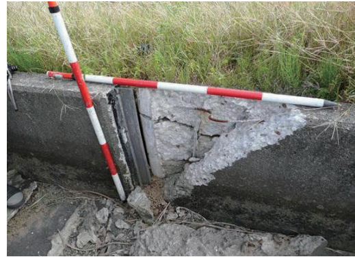
Fig.2-9 地震による側壁コンクリートの剥落 Exfoliation of sidewall concrete due to earthquake
