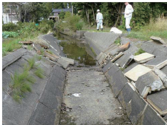
Fig.2-29 ブロックの崩落 Breakage and collapse of concrete blocks
