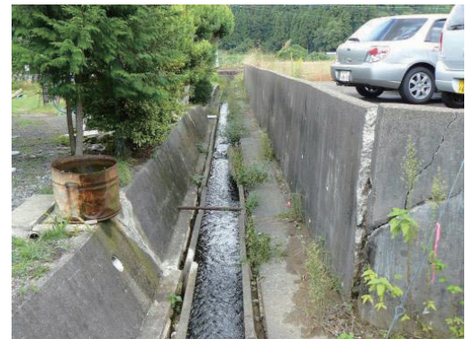
Fig.2-35 高盛土に近接した水路における側壁の倒壊 Collapse of canal sidewall besides a high embankment
