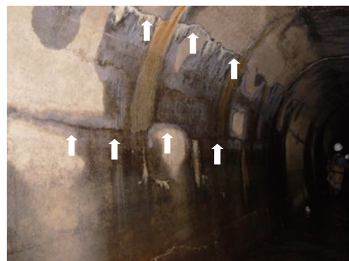
Fig.3-15 トンネル覆工に発生したひび割れの例 Cracks at the surface of a tunnel concrete lining
