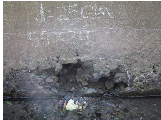
Fig.2-7 ジャンカが徐々に洗掘されてきたと思われる断面欠損 Losses in concrete cross-sectional area with progress of honeycomb
