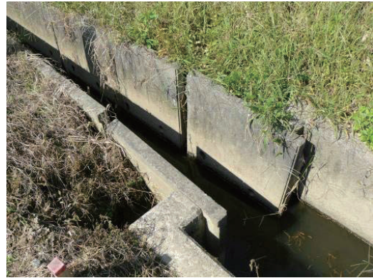
Fig.2-34 二次製品水路における目地の開き Separation of a precast concrete canal joint
