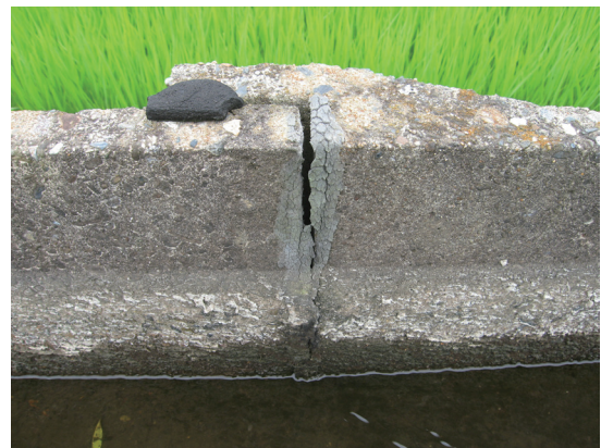
Fig.5-13 シーリング材による補修箇所の変状 Defective events on sealant materials
