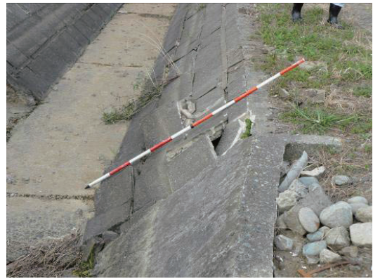
Fig.2-30 ブロックの捲れあがり Damage of concrete blocks
