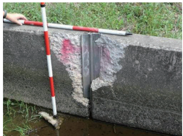
Fig.2-26 目地部コンクリートの剥落 Stripping of concrete at a canal joint
