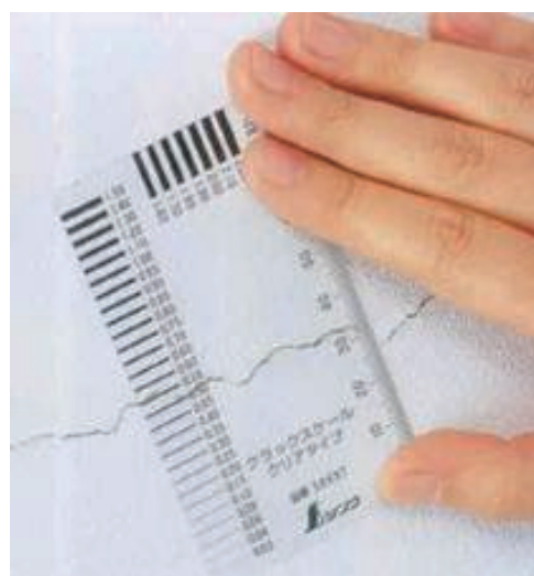
Fig.3-1 クラックスケールによるひび割れ幅の測定 Measurement of the crack width by crack scale
