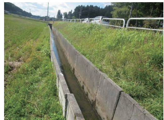
Fig.2-36 高盛土に近接した水路における側壁の変形 Deformation of canal sidewall besides a high embankment
