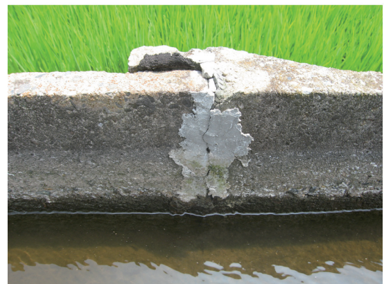
Fig.5-12 セメントモルタル系補修材による補修箇所の変状 Defective events on repair materials (cement mortar)
