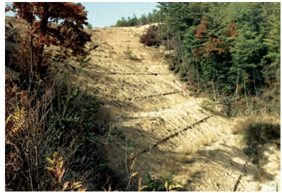
法面では侵食が発生している
