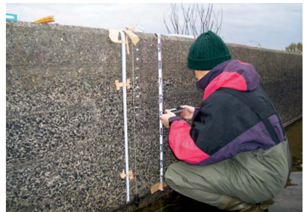
Fig.22 型取りゲージによる水路壁面の凹凸測定 Roughness Measurement of Canal with Roughness Profile
