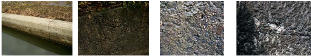
(1) 健全度 4.0 (セメントペーストの流出) (2) 健全度 3.0 (細骨材の流出) (3) 健全度 2.0 (粗骨材の露出) (4) 健全度 1.0 (粗骨材の剥離)
