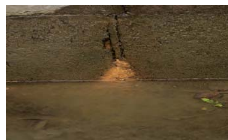
継目からの漏水
