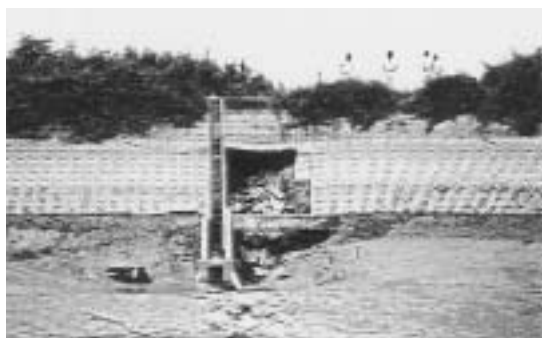
Photo 3-23 宝谷ため池決壊状況 (上流から決壊部を望む) Takaratani dam (viewed from upstream)
