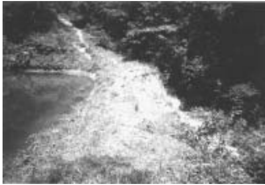
Photo 4-1 蚤屋敷中ため池の被災写真（右岸側より撮影） Nomiyashikinaka dam
