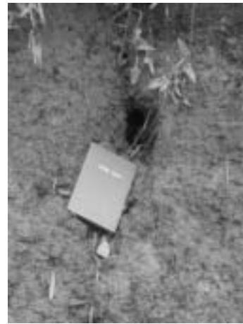
Photo 3-13 山崎ため池上流斜面の穴 (拡大) Hall on upstream slope of Yamazaki dam
