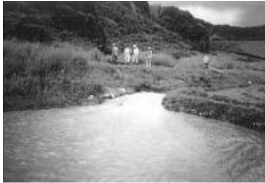
Photo 3-5 星ヶ谷ため池の漏水発生状況(下流より撮影) Leakage from embankment from Hoshigatani dam
