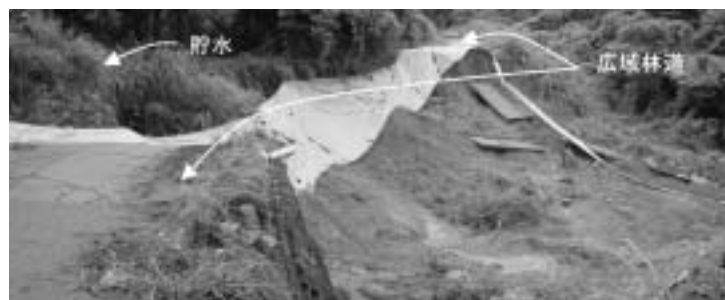
Photo 4-5 青野堤ため池の下流斜面すべり(右岸側地山より撮影) Sliding on the downstream slope of Aonotutumi dam
