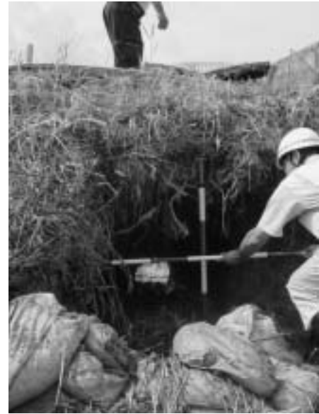
Photo 3-6 点Aのパイピングホール(上流側より撮影) Piping hall at point A
