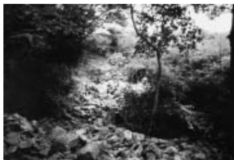
Photo 5-3 二千六百紀ため池の被災状況（下流より撮影） Nisenroppyakki dam (viewed from downstream)
