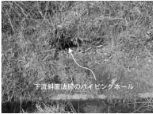
Photo 3-10 山崎ため池の下流斜面のパイピングホール A piping hall on the downstream slope of Yamazaki dam
