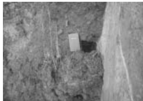
Photo 3-25 開削の結果発見されたパイピングホール Piping hall found after an excavation
