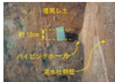
Photo 6-5 開削の結果発見されたパイピングホール(図 3-25 の再掲) Entrance of leakage path found after excavation
