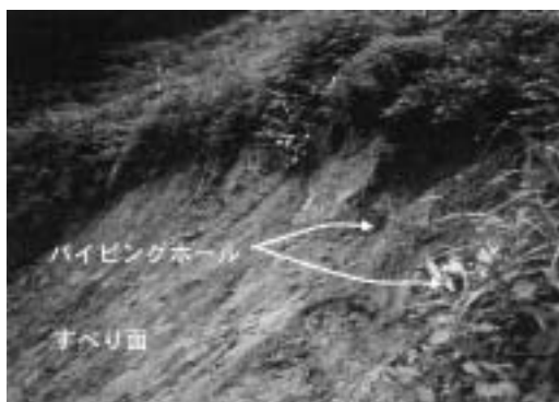
Photo 4-3 大溜1号ため池下流斜面のすべり面(日本農業土木総合研究所, 1998) Sliding surface on the downstream slope of Ootameichigo dam
