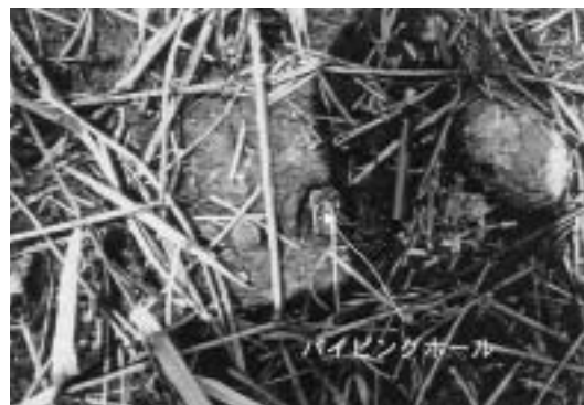
Photo 4-4 大溜1号ため池下流斜面のパイピングホール (日本農業土木総合研究所, 1998)
