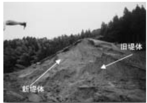
Photo 3-21 麻生ため池の決壊面と旧堤体 (上流側から右岸決壊面を望む) Breach section and old embankment
