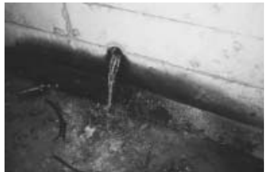
Photo 3-24 洪水吐水路排水孔（点 I）からの漏水 （写真は貯水位が洪水吐クレストより約 20cm 下の状態のときに撮影） Leakage from a drain pipe on the spillway (Point I)
