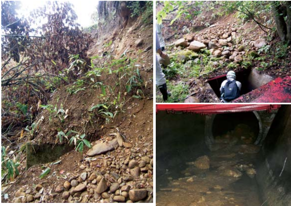
Fig.10 大原堰用水路下流トンネル出口の崩落状況（左，手前コンクリートは出口補強部）， 下流トンネル出口（右上），下流トンネル出口から内部の状況（右下）（Fig.7，②地点）
