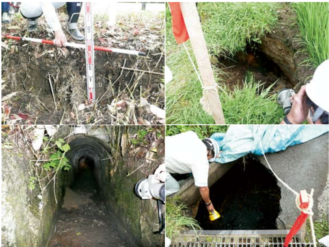
Fig.17 下真坂用水3号トンネルの被災(左上:トンネル入り口上部の地盤沈下による段差 (Fig.12, ⑥地点), 左下:トンネル入り口付近の土砂崩落, 右上:トンネル出口 (Fig.12, ⑦地点)直上流上部の地盤の陥没(約2m深さの亀裂), 右下:トンネル出口付近の地盤の陥没)
