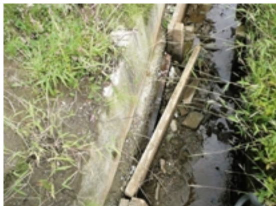
Fig.50 コンクリート柵渠柵板の崩落
