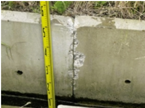
Fig.54 目地部コンクリートの剥落 Stripping of concrete at a canal joint
