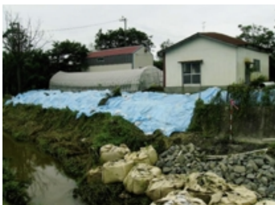
Fig.2 地山が崩壊して水路を塞ぎ止めている状態 Drainage canal dammed by slope collapse
