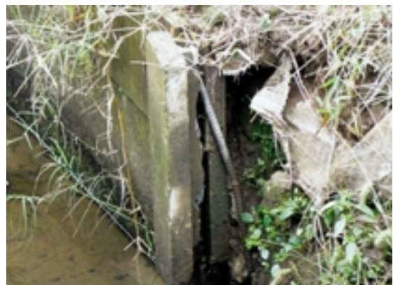
Fig.34 コンクリート柵渠における柵留め杭の破損 Damage to guard pile of a concrete drainage canal
