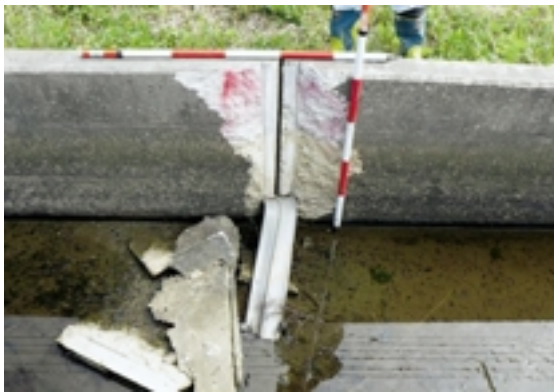
Fig.6 目地部におけるコンクリートおよび止水板の剥落 Stripping of concrete and dislodging of a water stop at a canal joint
