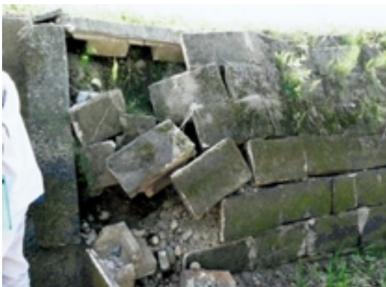
Fig.13 積ブロック水路におけるブロックの崩落 Breakage and collapse of concrete blocks lining a canal
