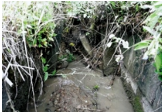
Fig.45 背面土の崩壊により倒壊したコンクリート柵渠 Tilting of a drainage canal
