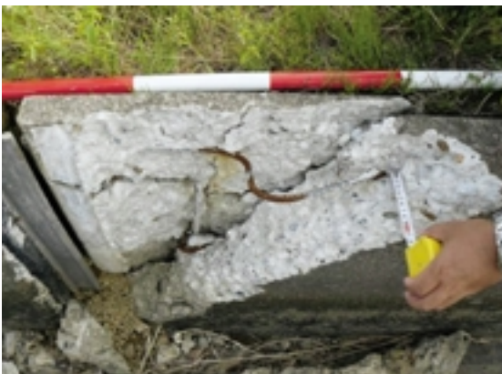
Fig.25 目地部コンクリートが剥落し鉄筋が変形・露出している状況 Concrete breakage and collapse exposing reinforcing at a canal joint
