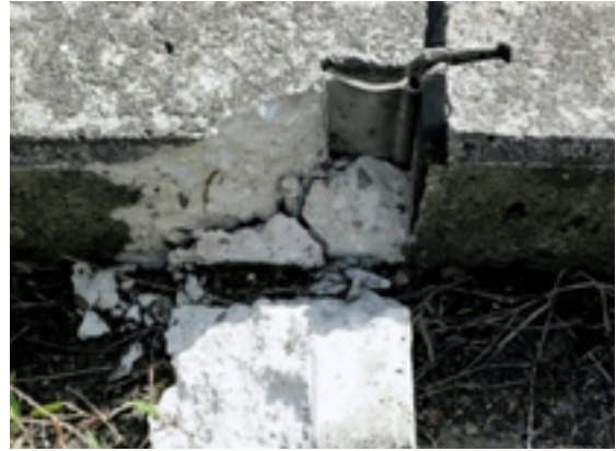
Fig.20 水路側壁目地部外側におけるのコンクリートの剥落・鉄筋露出 Stripping of concrete and exposure of reinforcing on the outer side of a canal joint
