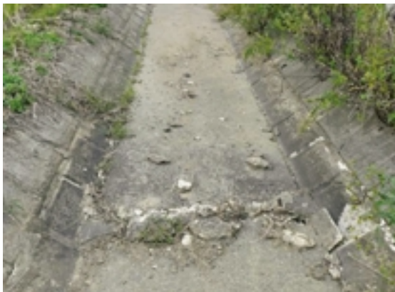
Fig.30 張ブロック水路における底版の亀裂 Crack in canal floor and damage to concrete blocks lining the canal
