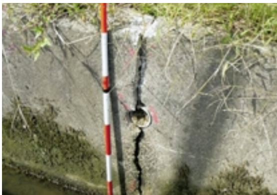
Fig.43 現場打ちコンクリート三面張水路における水抜孔付近のひび割れ
