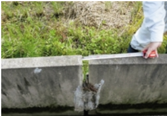
Fig.42 排水フリームにおける目地の開き Expansion of a joint in a drainage flume
