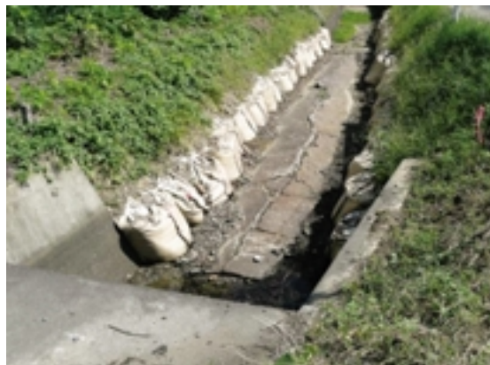
Fig.14 積ブロック水路における底版の曲げ破壊 Bending, cracking, and tilting of floor of concrete blocks lining a canal
