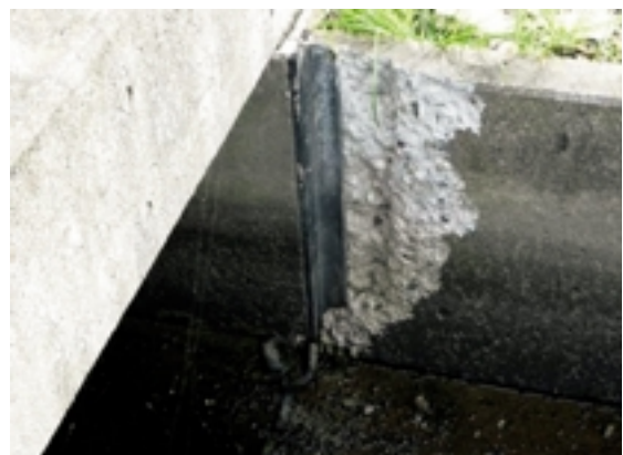
Fig.22 目地部におけるコンクリートの剥落 Stripping of concrete at a canal joint
