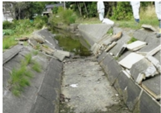
Fig.27 張ブロック水路におけるブロックの崩落 Broken fragments from a concrete block wall lining falling into a canal
