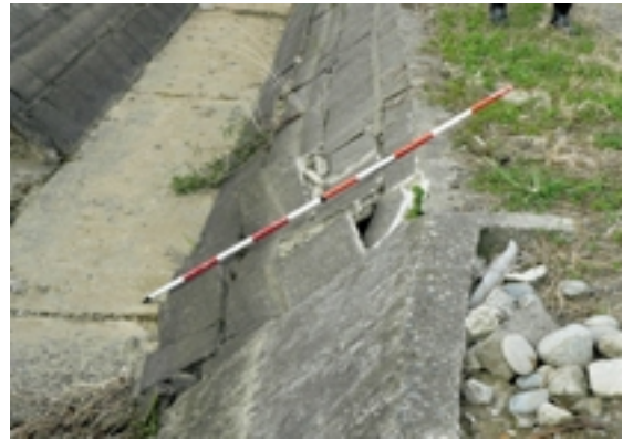
Fig.26 張ブロック水路におけるブロックの捲れあがり Damage to concrete blocks in the wall lining a canal
