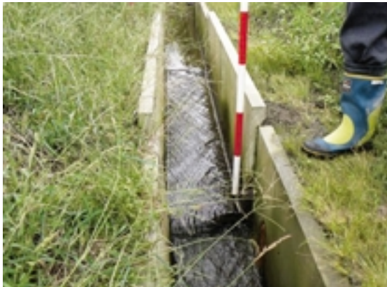
Fig.53 躯体の浮き上がりによるずれ・段差 Uplift of a canal building frame
