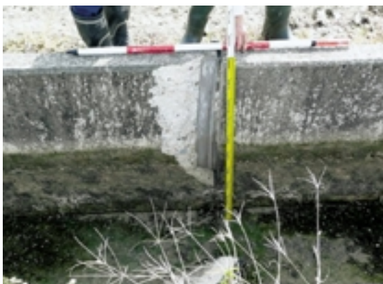
Fig.19 水路側壁目地部内側におけるのコンクリートの剥落 Stripping of concrete on the inside of a canal joint
