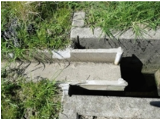
Fig.18 分水柵におけるベンチフリームの突出 Protrusion of a bench flume at a diversion device
