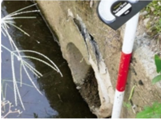
Fig.17 排水フリームにおける流入管の突出 Protrusion of the inflow tube at a drainage flume
