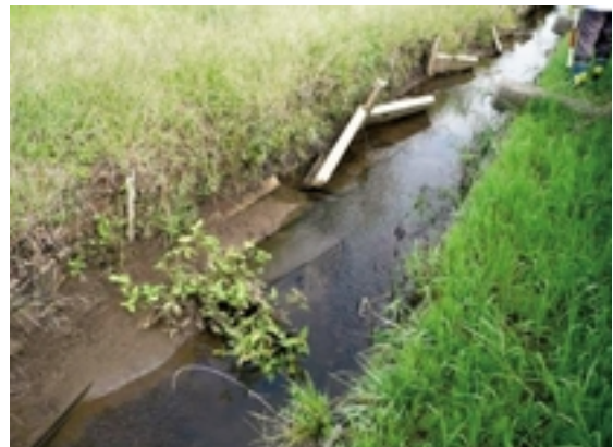
Fig.33 コンクリート柵渠における柵板の崩落 Breakage and collapse of fence boards of a drainage canal
