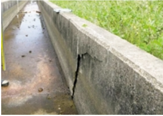
Fig.5 側壁目地付近コンクリートの剥離 Stripping of concrete at a sidewall joint in a canal
