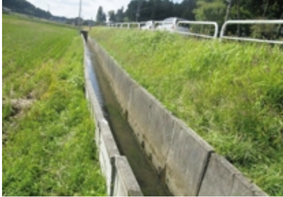
Fig.41 水路脇法面の押し出しによる排水フリーム側壁の変位
