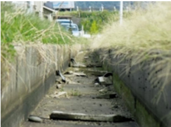
Fig.24 目地部コンクリートや止水板が連続して剥落している状況 Repeated breakage of concrete and collapse of water stops at successive canal joints
