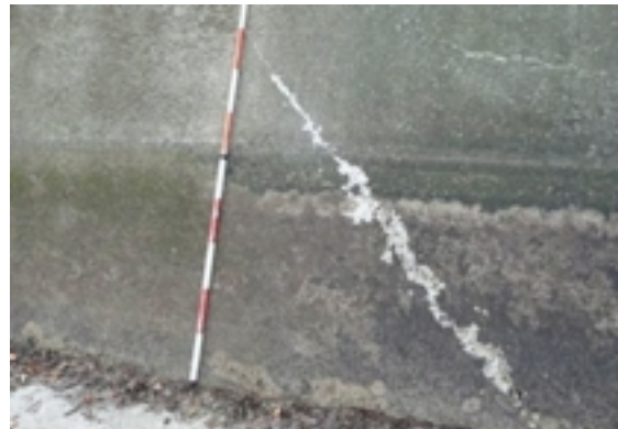
Fig.9 もたれ擁壁水路におけるひび割れ Crack in concrete canal retaining wall
