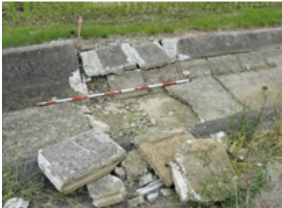
Fig.29 張ブロック水路におけるブロックの崩落 Breakage and collapse of concrete blocks lining a canal
