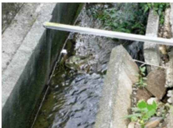
Fig.48 変形したベンチフリュームの側壁 Deformation of a sidewall bench flume
