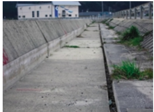
Fig.22 護岸工全体の海側への移動と沈下（新保地区） Lateral movement of seawall and settlement of road
