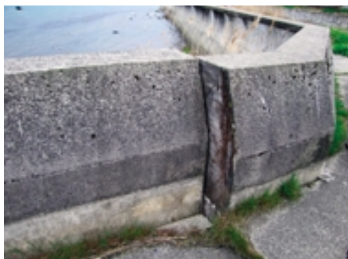
Fig.6 波消しブロックの海側への移動 Lateral deformation of seawall
