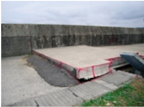
Fig.18 護岸工全体の沈下（塩津地区） Settlement of seawall
