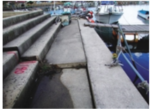
Fig.11 コンクリート床版と階段工の沈下 Settlement of seawall
