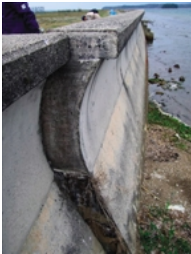
Fig.5 波消しブロックの変位（外地区） Inclining of Seawall
