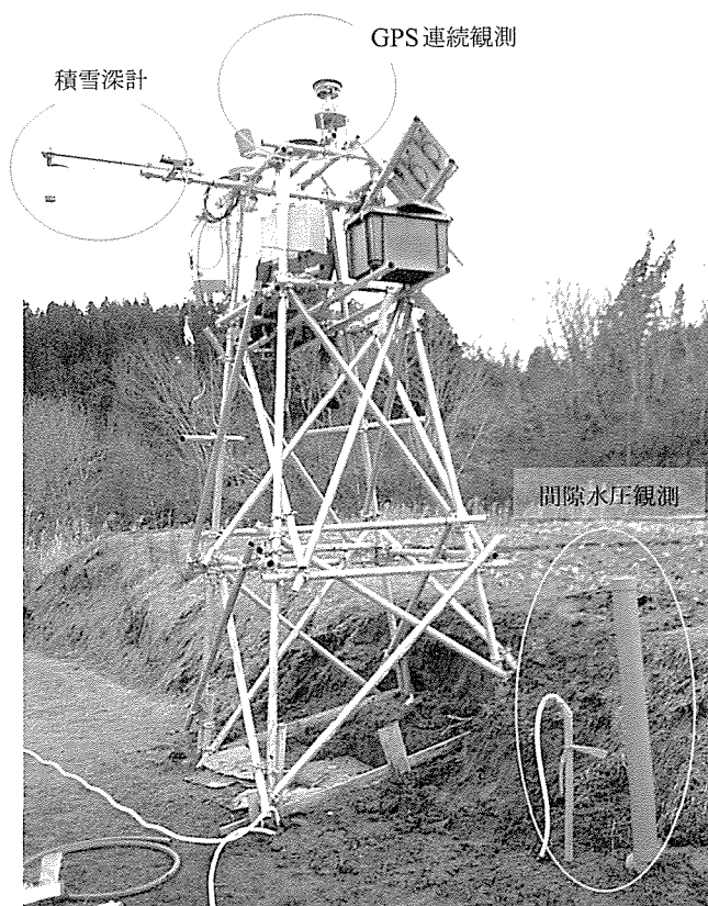
Photo 6 緊急時にも対応可能な地すべり地土塊移動量および間隙水圧の連続観測システム (旧栃尾市C地区)
