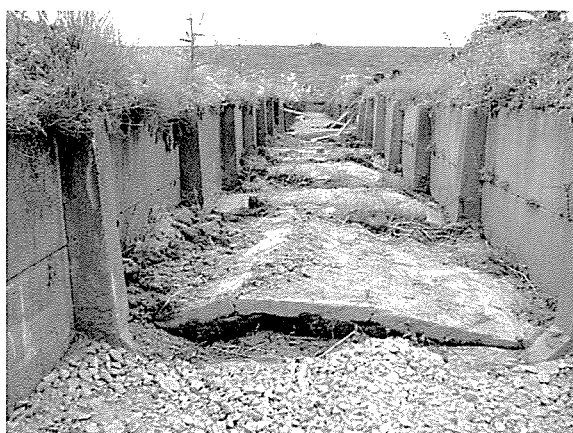
Photo 30 インバートの曲げ破壊 Bending failure of invert
