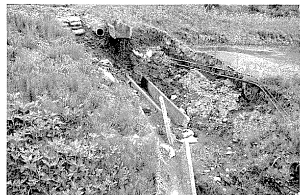
Photo 2 ベンチフリュームの損傷 Damage of concrete bench flumes
