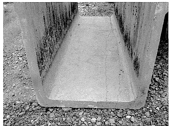
Photo 18 インパートの曲げ破壊(BF600) Bending failure of invert
