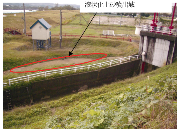
Fig.13 液状化圧によると見られる水路側壁の傾斜（04.10） Inclining of the canal sidewall by the liquefaction pressure
