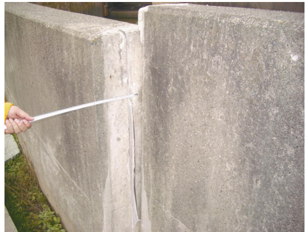
Fig.18 サイホン工上流継目の水平変位 (04.10) Horizontal displacing in the siphon inlet canal
