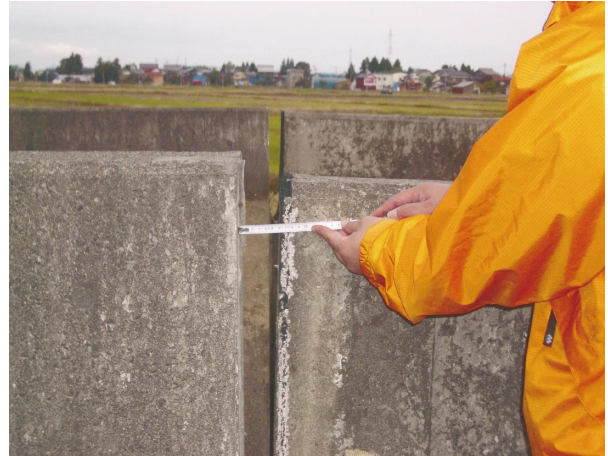
Fig.17 サイホン工上流開水路部継目の開き (04.10) Displacing of joint space in the siphon inlet canal
