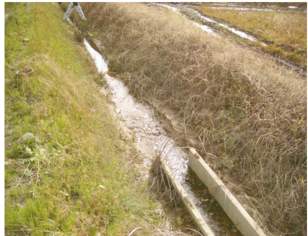
Fig.23 支線排水路（コンクリートフルーム）の沈下（04.10） Settlement of a tertiary drainage canal (concrete flume)
