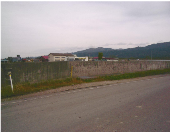
Fig.16 サイホン工上流部と水路部との変位 (04.10) The joint displacing in the siphon inlet canal
