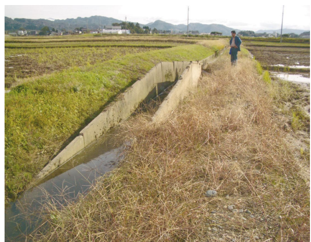
Fig.24-1 幹線排水路（フルーム）の変形（その1，04.10） Displacing of the main drainage canal (Flume)
