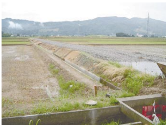
Fig.26 復旧された支線農道と末端用水路 (旧淡路町岩野, 2005.7.4撮影) Restored lateral road and farm ditch
