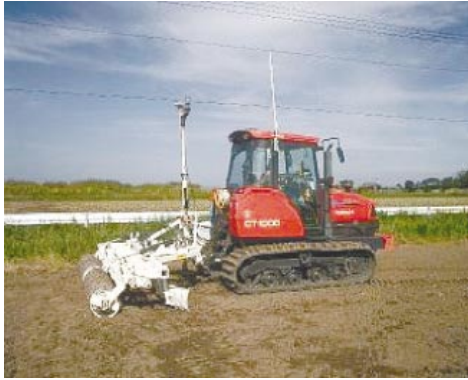
Fig.20 GPSレベラーによる整地均平 Land grading and leveling by GPS leveller
