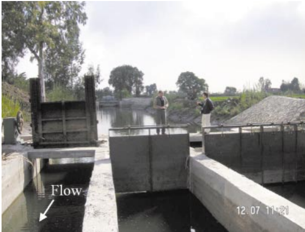
Fig. 14 ディストリビュータに併設された全開放状態の緊急放流ゲート (Dsook地区)
