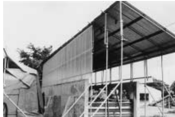
写真 17 試験バンカーサイロに設置した屋根 Photo 17 Roof attached to test bunker silo
