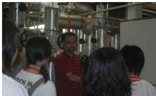
高野研究員の案内で、研究棟の機械室を見学する参加者
